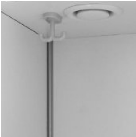
Soupape de ventilation
